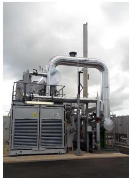
Vue de détail de la plateforme de valorisation biogaz
