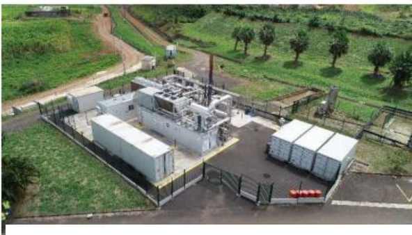
Vue d'ensemble de la plateforme de valorisation
